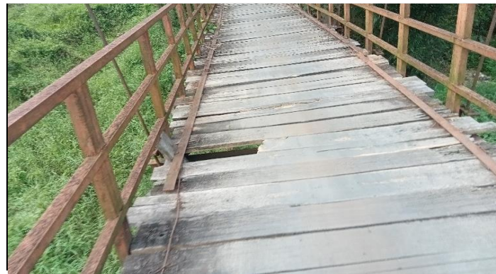
KONDISI LAPISAN PERMUKAAN LANTAI BERLUBANG
