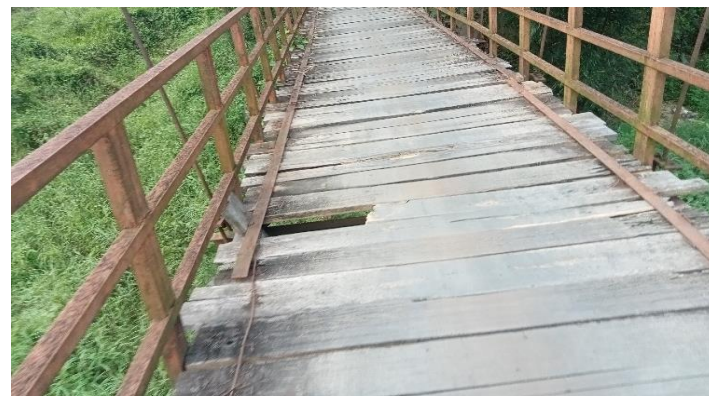
KONDISI LAPISAN PERMUKAAN LANTAI BERLUBANG
