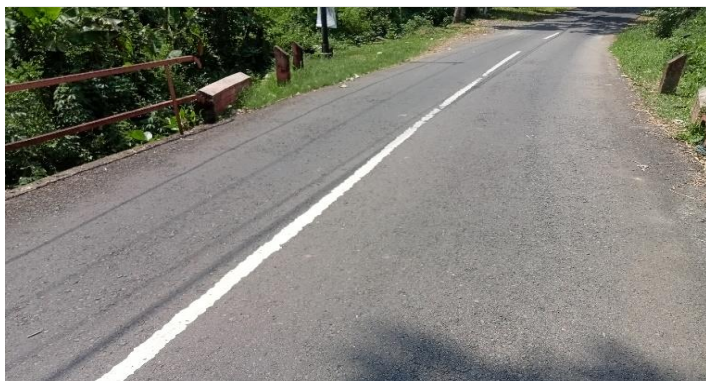
KONDISI LAPISAN PERMUKAAN LANTAI
