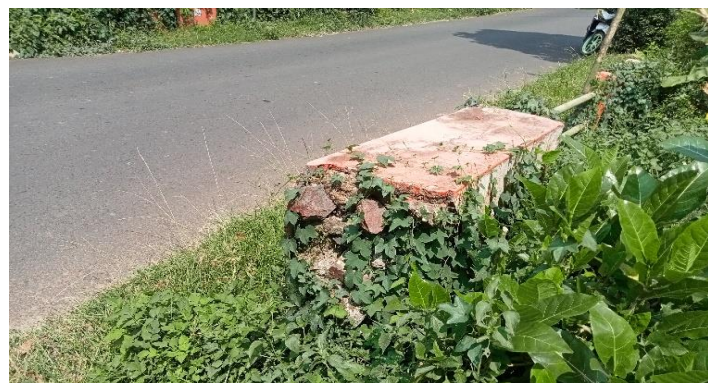
TEMBOK SEDADA / PARAPET PECAH
