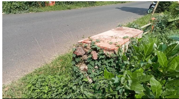
TEMBOK SEDADA / PARAPET PECAH
