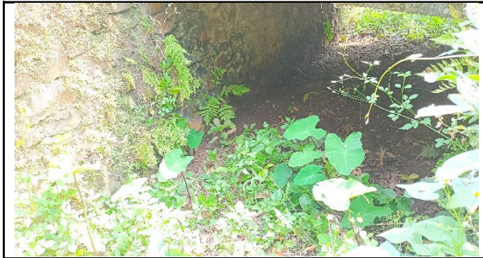
KONDISI KEPALA JEMBATAN MENGALAMI PENUAAN
