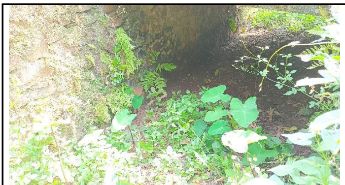
KONDISI KEPALA JEMBATAN MENGALAMI PENUAAN
