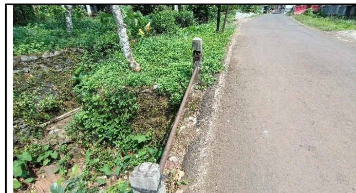
KERUSAKAN PADA SANDARAN JEMBATAN
