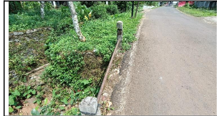
KERUSAKAN PADA SANDARAN JEMBATAN
