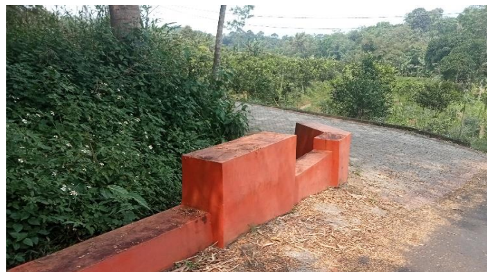
KONDISI SANDARAN / PARAPET
