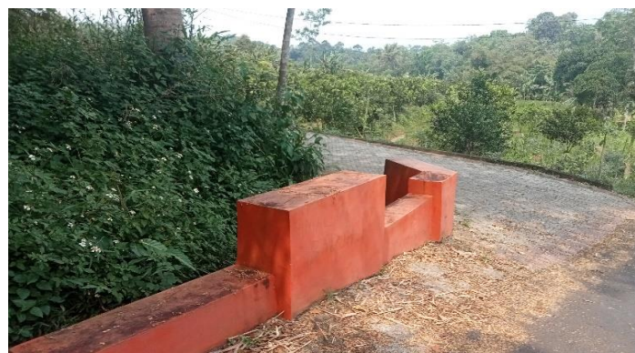
KONDISI SANDARAN / PARAPET
