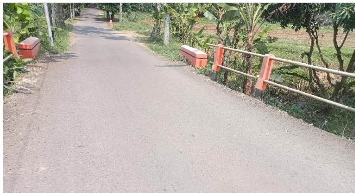
KONDISI LAPISAN PEMUKAAN LANTAI
