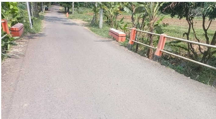
KONDISI LAPISAN PEMUKAAN LANTAI
