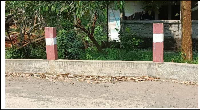
KONDISI TIANG SANDARAN
