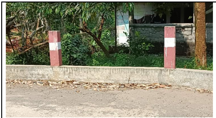
KONDISI TIANG SANDARAN
