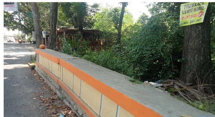
KONDISI SANDARAN/PARAPET TEMBOK SEDADA
