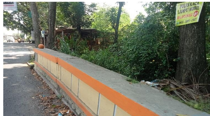
KONDISI SANDARAN/PARAPET TEMBOK SEDADA
