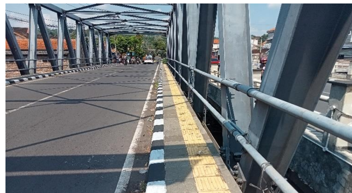
KONDISI SANDARAN DAN TROTOAR/KERB
