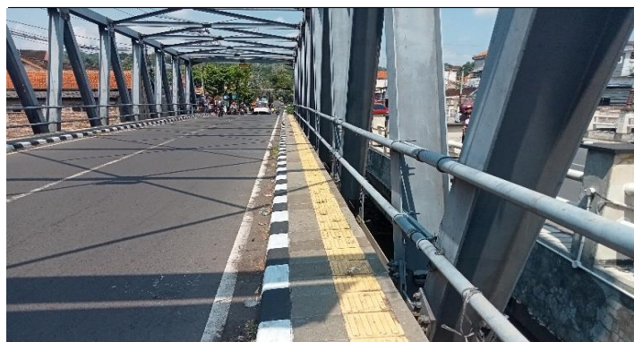
KONDISI SANDARAN DAN TROTOAR/KERB
