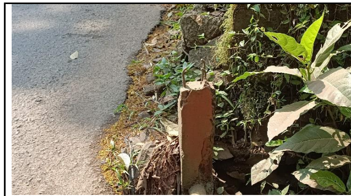
KERUSAKAN PADA SANDARAN
