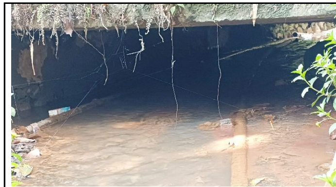
KONDISI PELAT JEMBATAN TERLALU RENDAH
