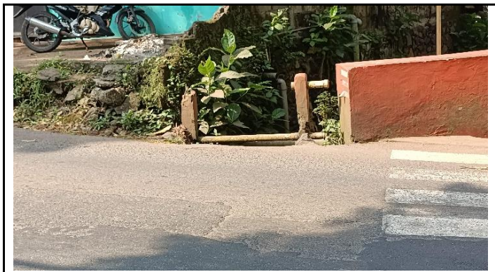
KONDISI LANTAI BERGELOMBANG
