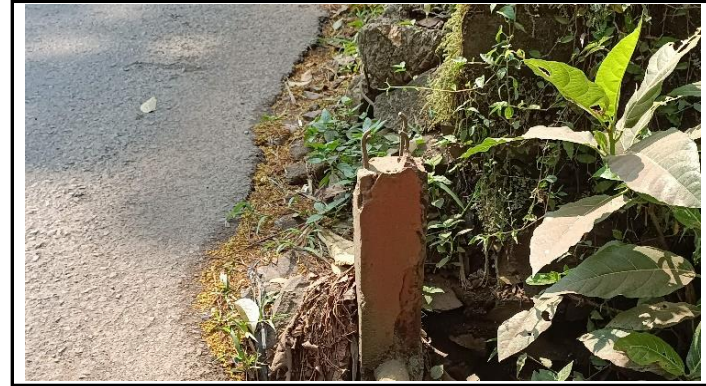
KERUSAKAN PADA SANDARAN
