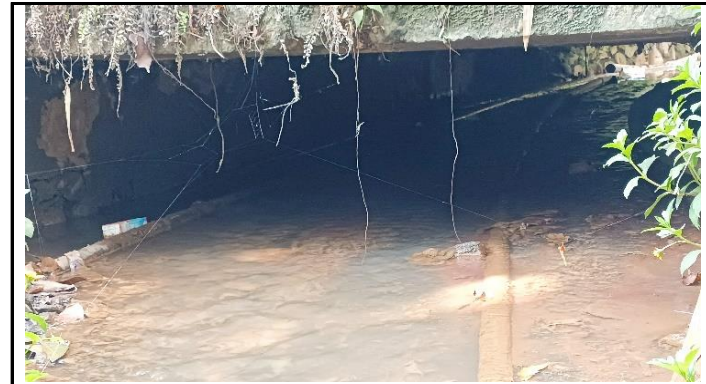
KONDISI PELAT JEMBATAN TERLALU RENDAH
