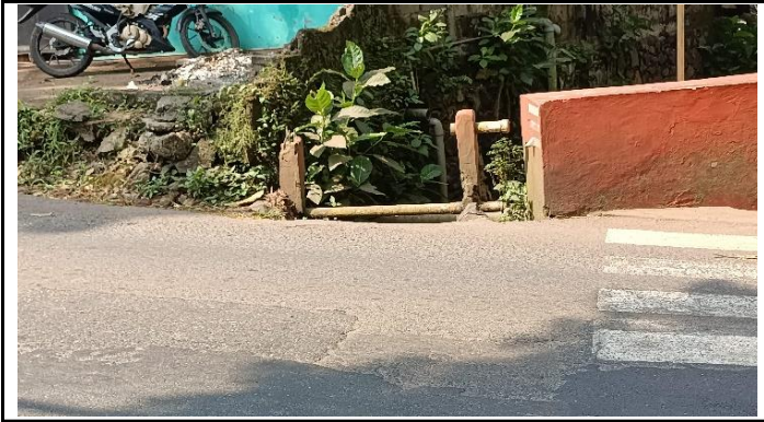
KONDISI LANTAI BERGELOMBANG
