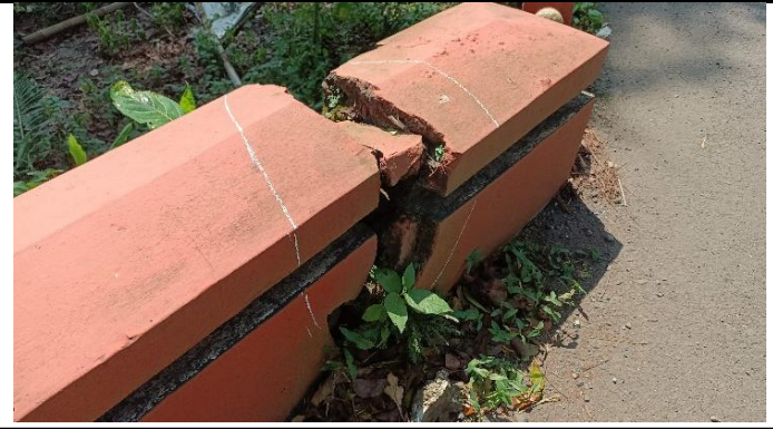
KONDISI PARAPET PECAH
