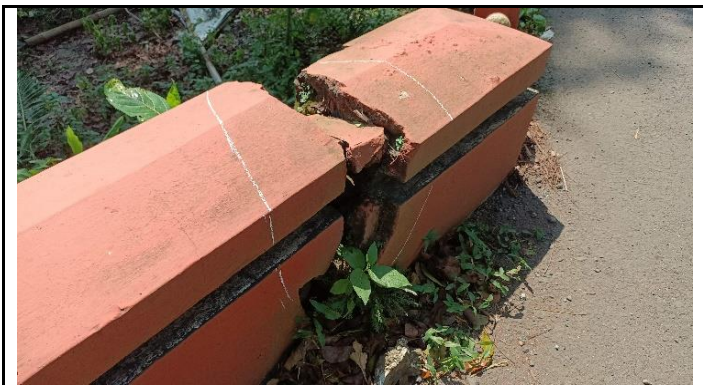
KONDISI PARAPET PECAH
