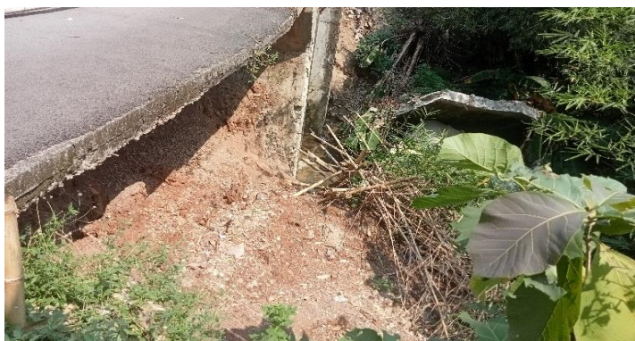
PERKERASAN JALAN PENDEKAT AMBLAS
