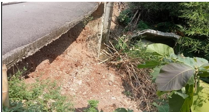
PERKERASAN JALAN PENDEKAT AMBLAS
