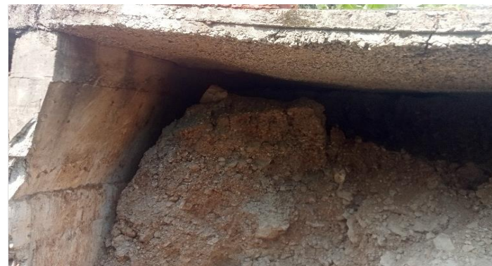
PERKERASAN JALAN PENDEKAT AMBLAS
