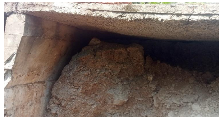
PERKERASAN JALAN PENDEKAT AMBLAS
