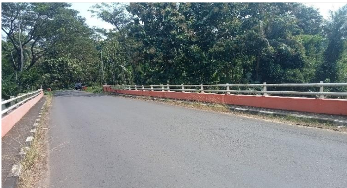
KONDISI LAPISAN PERMUKAAN LANTAI
