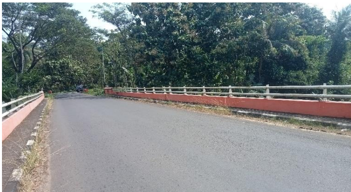
KONDISI LAPISAN PERMUKAAN LANTAI
