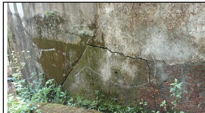
DINDING PENAHAN TANAH JALAN PENDEKAT RETAK
