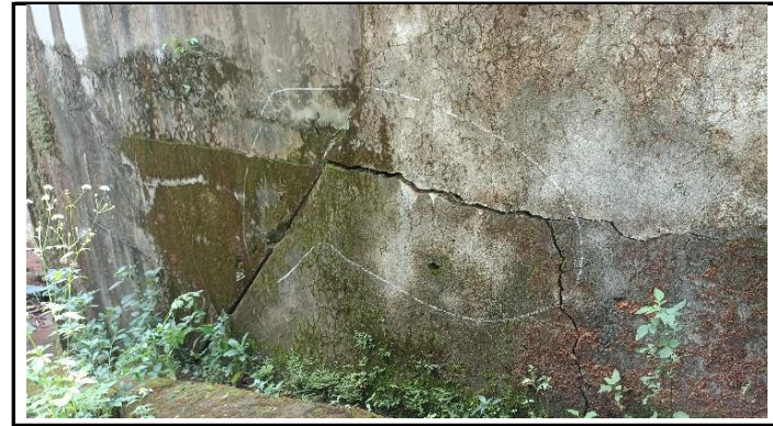
DINDING PENAHAN TANAH JALAN PENDEKAT RETAK
