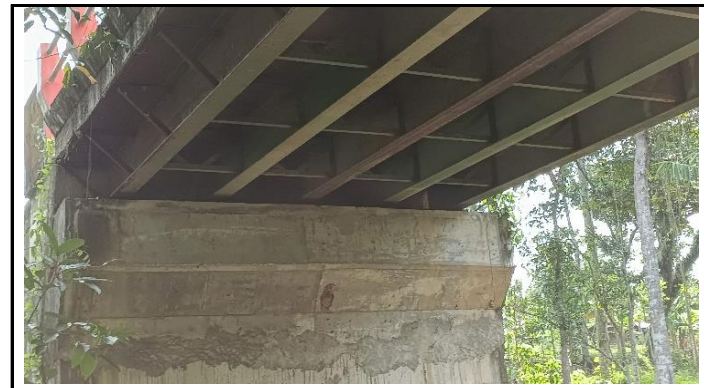
KONDISI GELAGAR DAN KEPALA JEMBATAN
