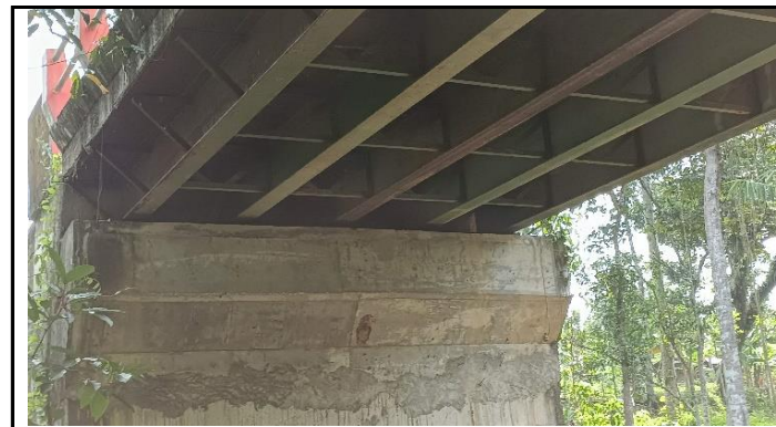
KONDISI GELAGAR DAN KEPALA JEMBATAN
