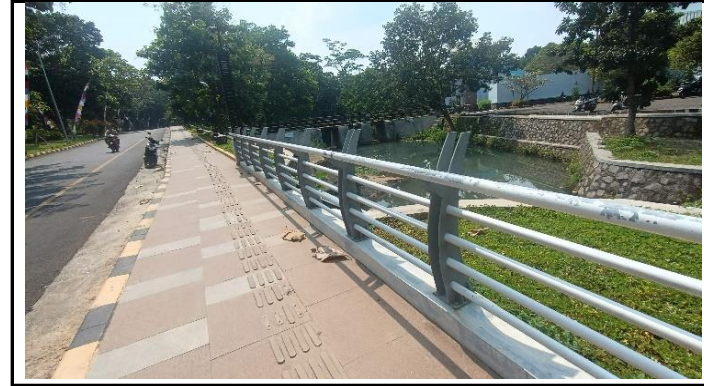
KONDISI TROTOAR DAN SANDARAN
