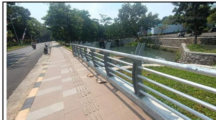
KONDISI TROTOAR DAN SANDARAN
