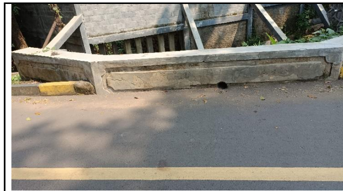
KONDISI PARAPET TERLALU RENDAH
