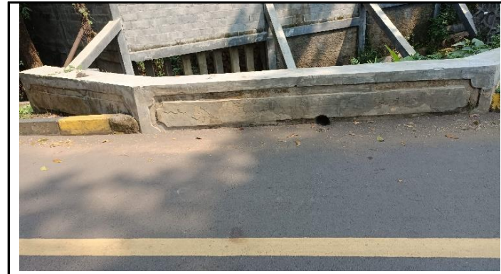
KONDISI PARAPET TERLALU RENDAH
