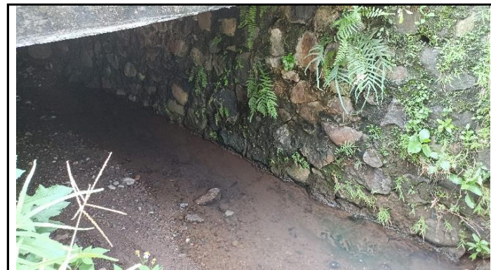
KEPALA JEMBATAN BERLUMUT DAN MENGALAMI PENUAAN
