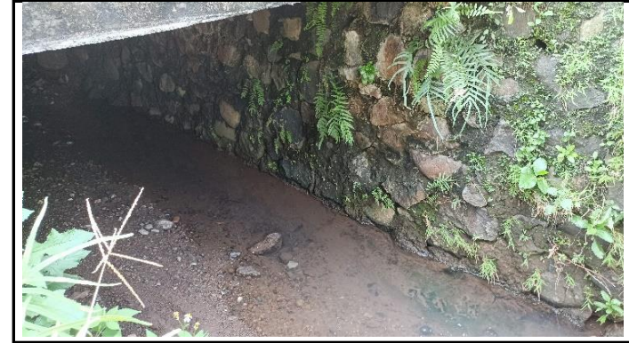
KEPALA JEMBATAN BERLUMUT DAN MENGALAMI PENUAAN
