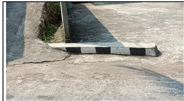
SANDARAN JEMBATAN TERLALU RENDAH
