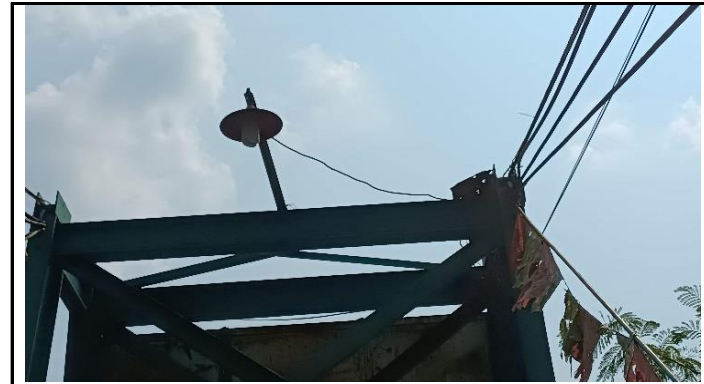
LAMPU PENERANGAN JEMBATAN
