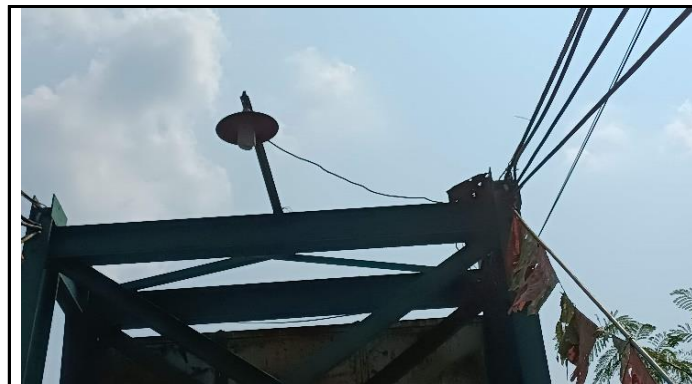
LAMPU PENERANGAN JEMBATAN
