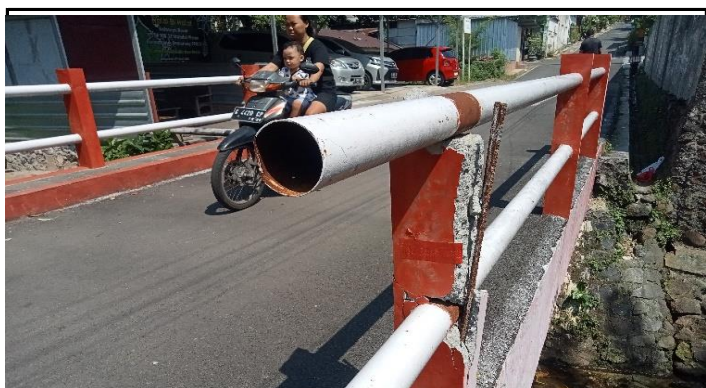
TIANG SANDARAN PECAH
