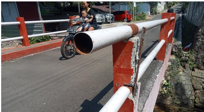
TIANG SANDARAN PECAH
