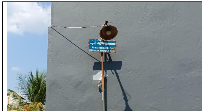
KONDISI PENERANGAN JEMBATAN
