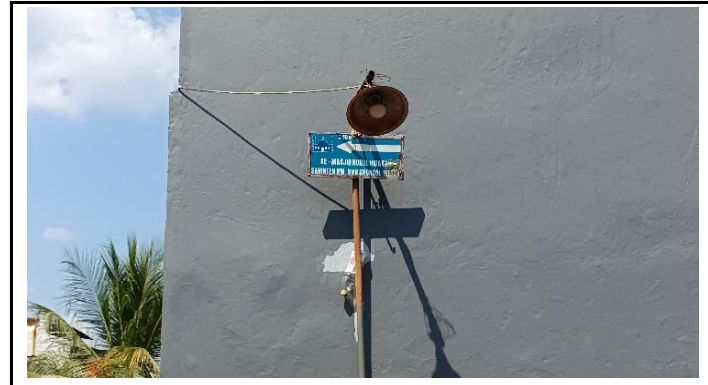
KONDISI PENERANGAN JEMBATAN
