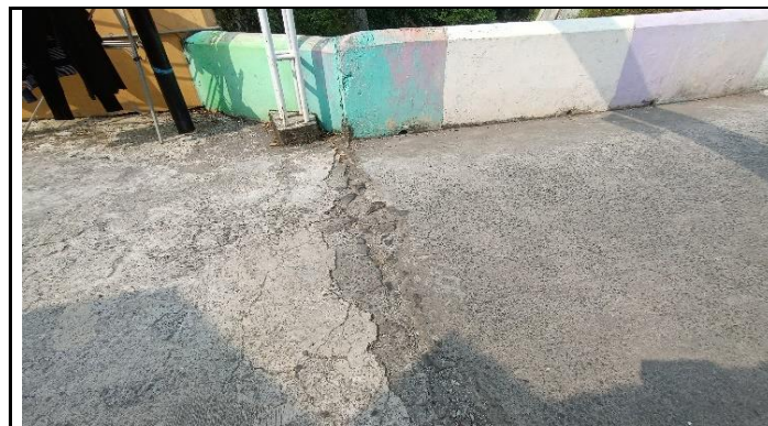
SAMBUNGAN LANTAI RETAK
