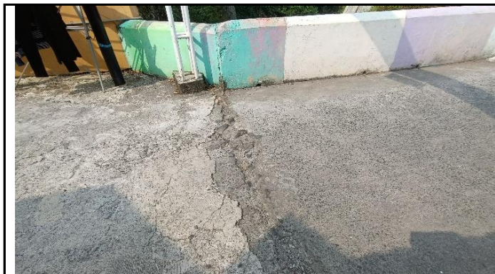
SAMBUNGAN LANTAI RETAK
