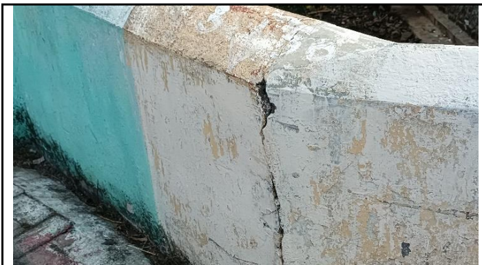
TEMBOK SEDADA RETAK
