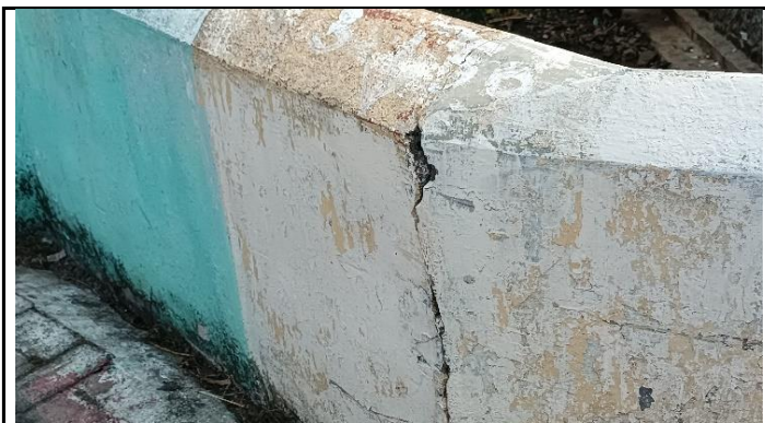
TEMBOK SEDADA RETAK
