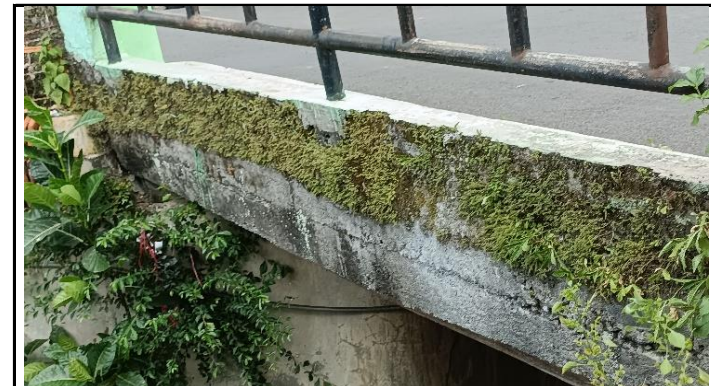
PELAT JEMBATAN BERLUMUT
