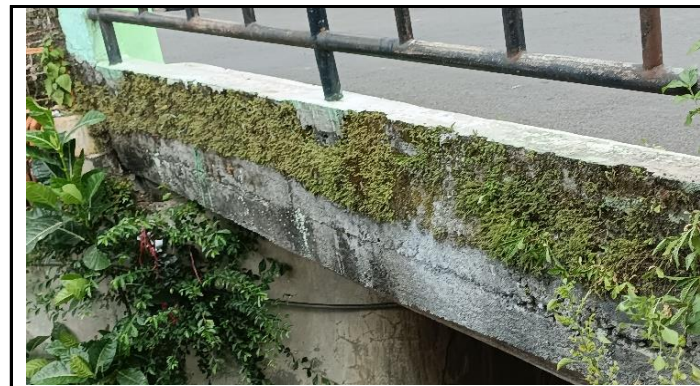
PELAT JEMBATAN BERLUMUT
