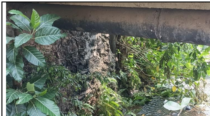
KONDISI KEPALA JEMBATAN DAN PIPA UTILITAS
