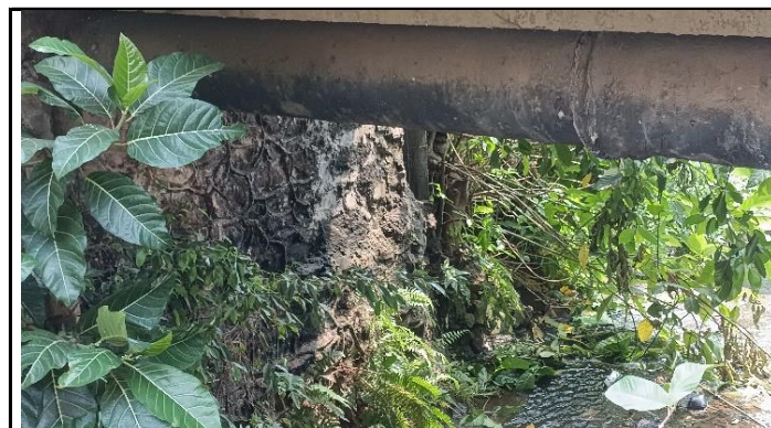
KONDISI KEPALA JEMBATAN DAN PIPA UTILITAS
