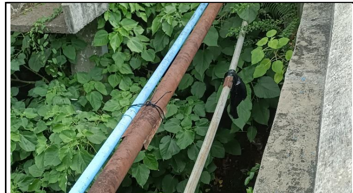
PIPA UTILITAS AIR MINUM BERKARAT
