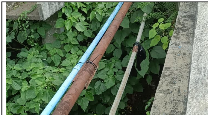
PIPA UTILITAS AIR MINUM BERKARAT
