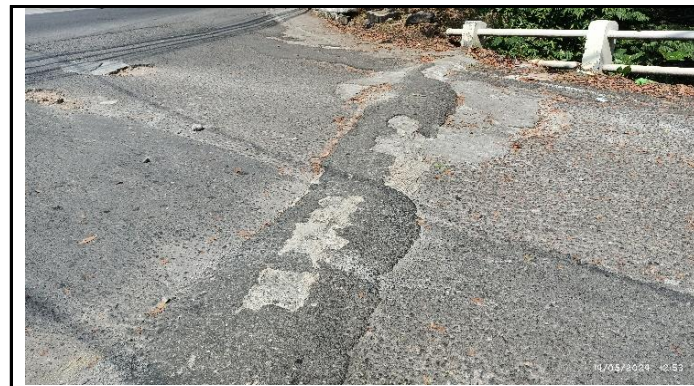
LAPISAN PERMUKAAN LANTAI BERLUBANG
