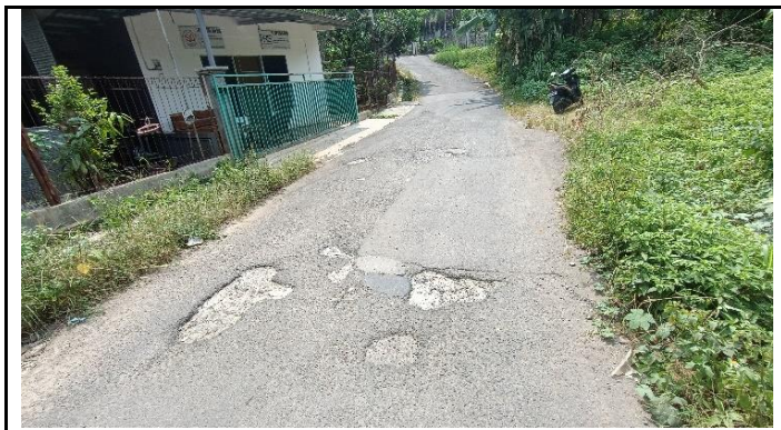
LAPISAN PERMUKAAN LANTAI JALAN PENDEKAT BERLUBANG
