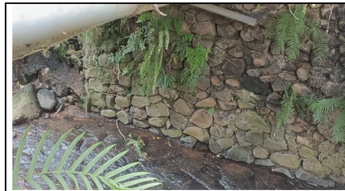
KEPALA JEMBATAN MENGALAMI PENURUNAN MUTU
