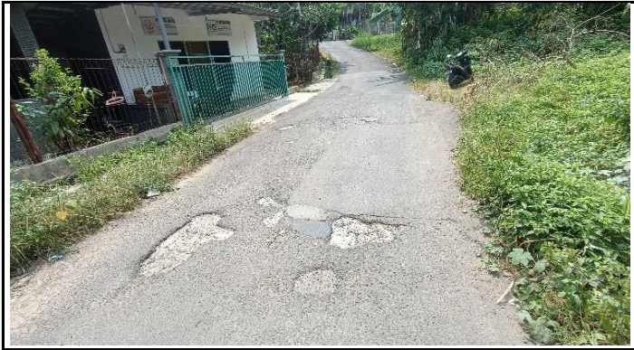
LAPISAN PERMUKAAN LANTAI JALAN PENDEKAT BERLUBANG
