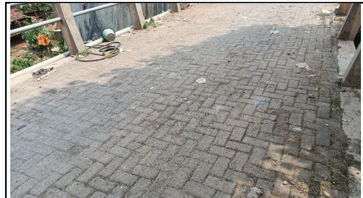
KONDISI LAPISAN PERMUKAAN LANTAI
