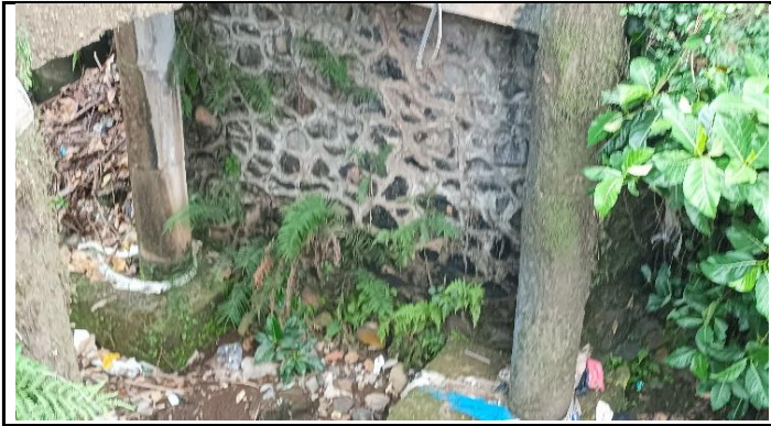
KEPALA JEMBATAN MENGALAMI PENURUNAN MUTU
