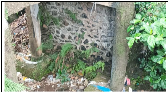
KEPALA JEMBATAN MENGALAMI PENURUNAN MUTU
