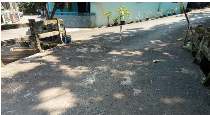
KONDISI LAPISAN PERMUKAAN LANTAI
