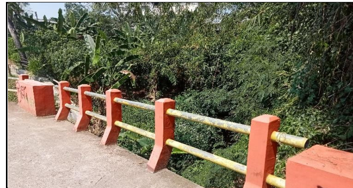
KONDISI SANDARAN SISI KANAN
