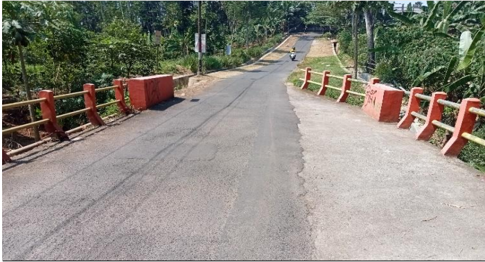
KONDISI LAPISAN PERMUKAN LANTAI
