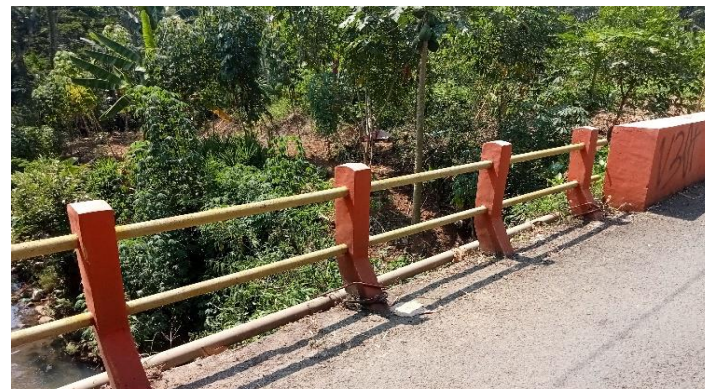
KONDISI SANDARAN SISI KIR
