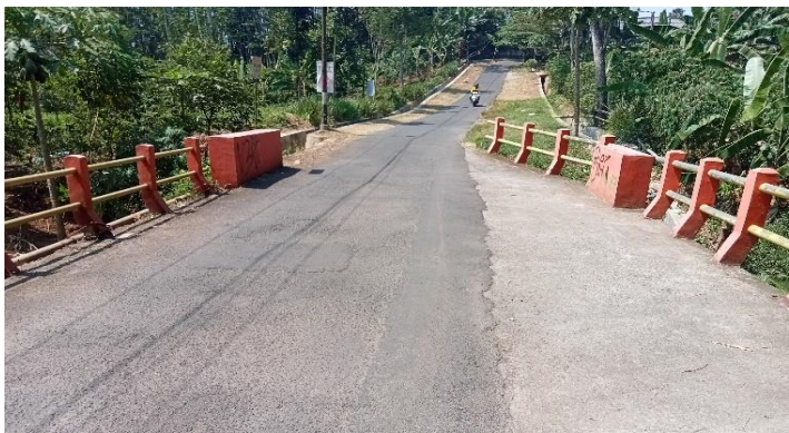
KONDISI LAPISAN PERMUKAN LANTAI
