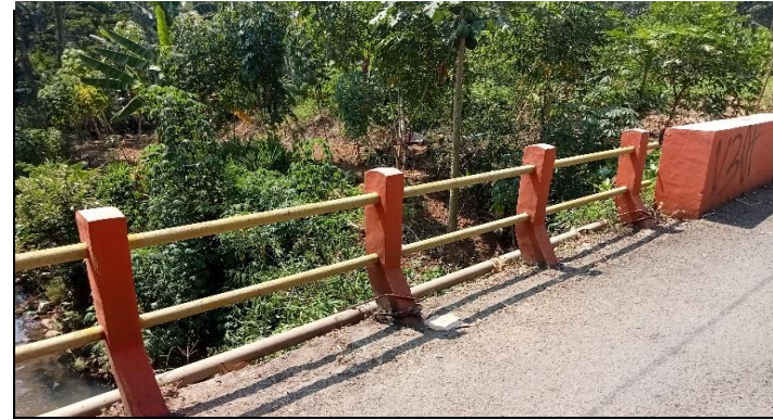
KONDISI SANDARAN SISI KIR
