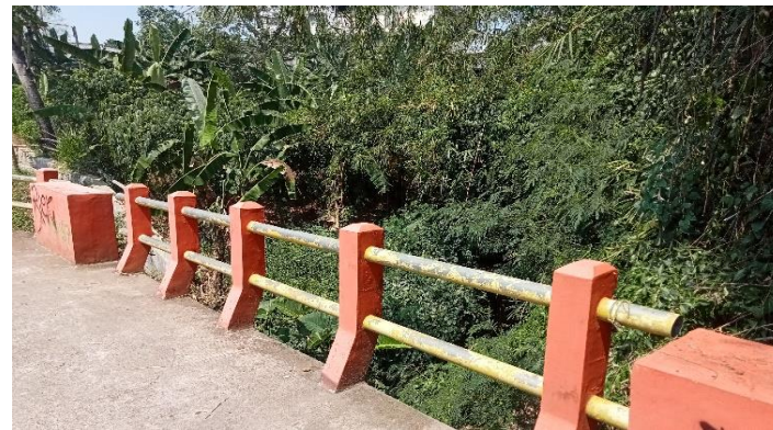
KONDISI SANDARAN SISI KANAN
