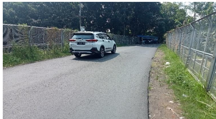
KONDISI LAPIUSAN PERMUKAAN LANTAI
