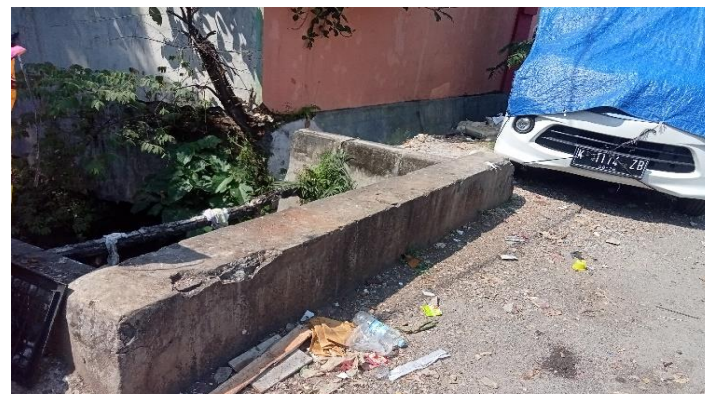
KONDISI SANDARAN / PARAPET
