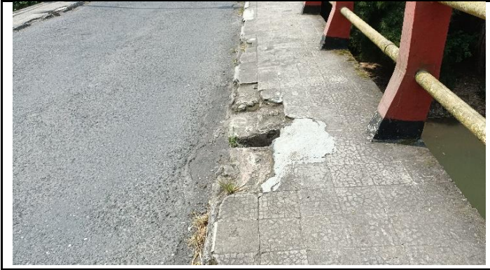
KONDISI TROTOAR PECAH
