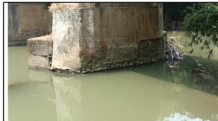
KONDISI PILAR MENGALAMI PENURUNAN MUTU
