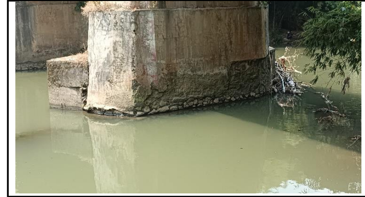
KONDISI PILAR MENGALAMI PENURUNAN MUTU
