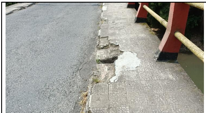
KONDISI TROTOAR PECAH
