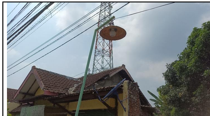
KONDISI LAMPU PENERANGAN
