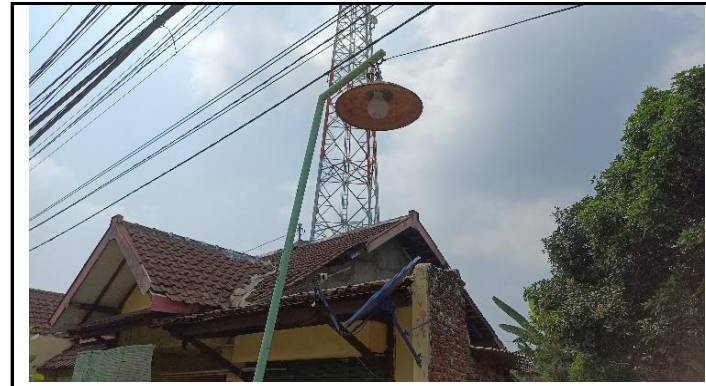
KONDISI LAMPU PENERANGAN
