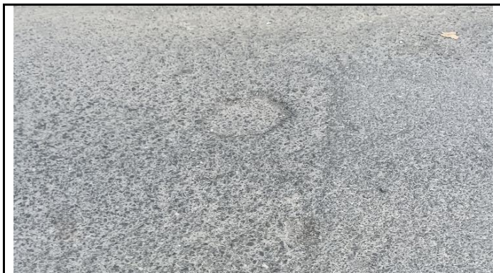
LAPISAN PERMUKAAN LANTAI BERLUBANG
