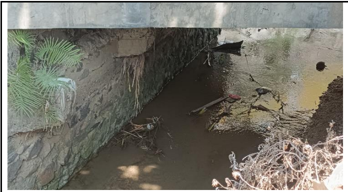
KONDISI KEPALA JEMBATAN BERLUMUT
