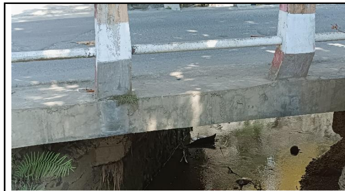
KONDISI PELAT JEMBATAN
