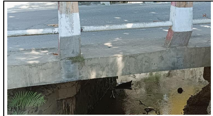
KONDISI PELAT JEMBATAN
