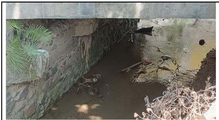
KONDISI KEPALA JEMBATAN BERLUMUT
