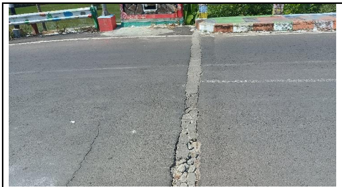
KERETAKAN PADA SAMBUNGAN LANTAI
