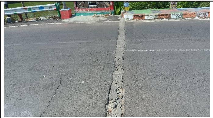
KERETAKAN PADA SAMBUNGAN LANTAI
