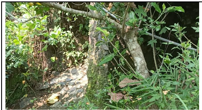
KEPALA JEMBATAN DAN PILAR MENGALAMI PENURUNAN MUTU
