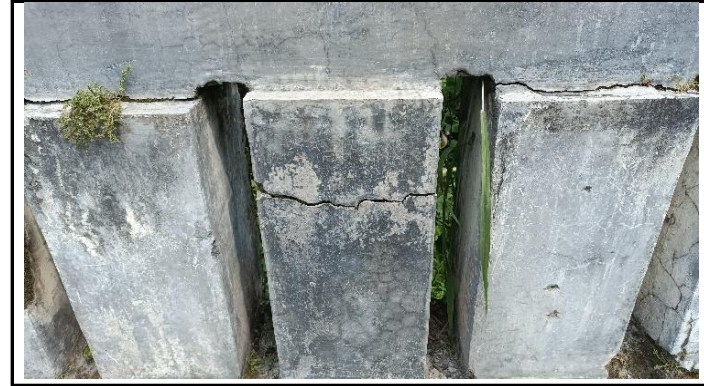
KERETAKAN PADA SANDARAN
