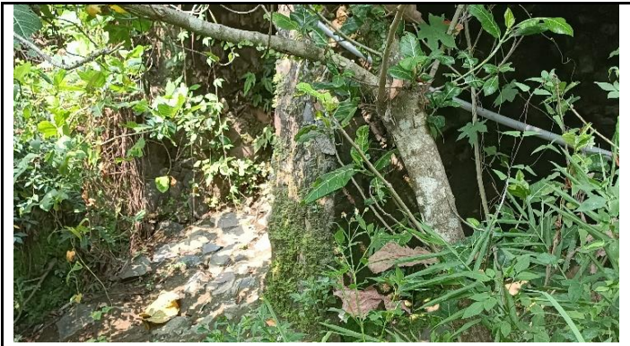
KEPALA JEMBATAN DAN PILAR MENGALAMI PENURUNAN MUTU
