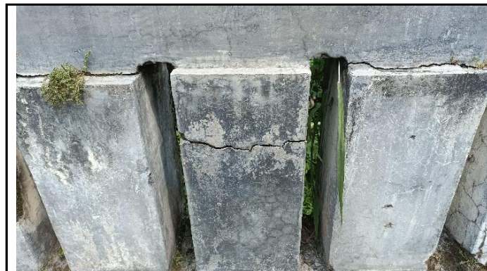
KERETAKAN PADA SANDARAN
