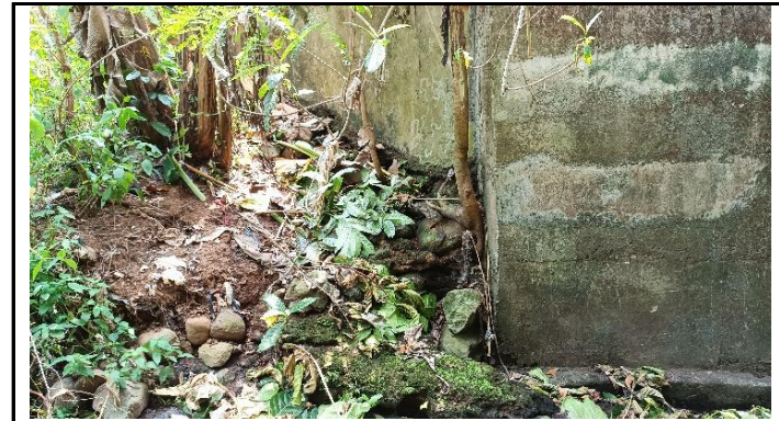
KONDISI DINDING PENAHAN TANAH JALAN PENDEKAT
