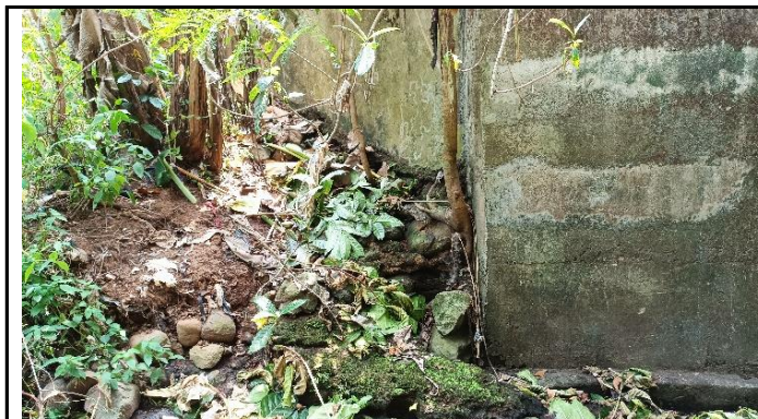
KONDISI DINDING PENAHAN TANAH JALAN PENDEKAT
