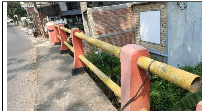
KONDISI SANDARAN TERKELUPAS PADA CAT
