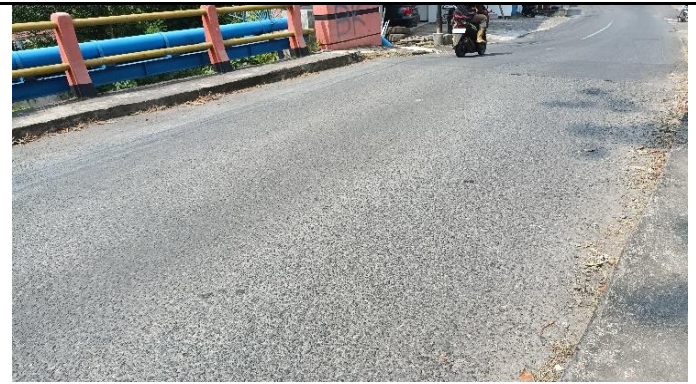
KONDISI LAPISAN PERMUKAAN LANTAI
