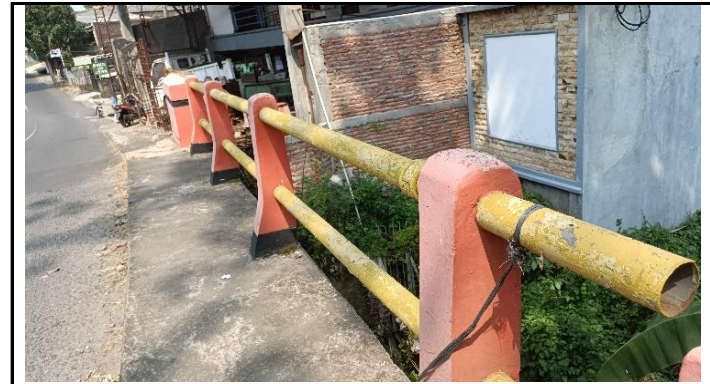
KONDISI SANDARAN TERKELUPAS PADA CAT
