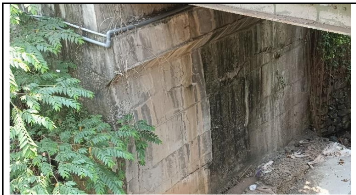
KONDISI KEPALA JEMBATAN BERLUMUT
