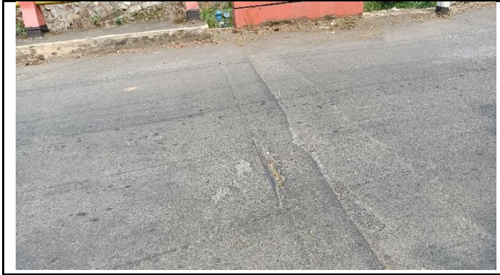
LAPISAN PERMUKAAN LANTAI BERGELOMBANG
