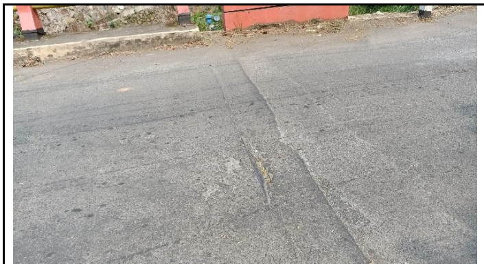
LAPISAN PERMUKAAN LANTAI BERGELOMBANG
