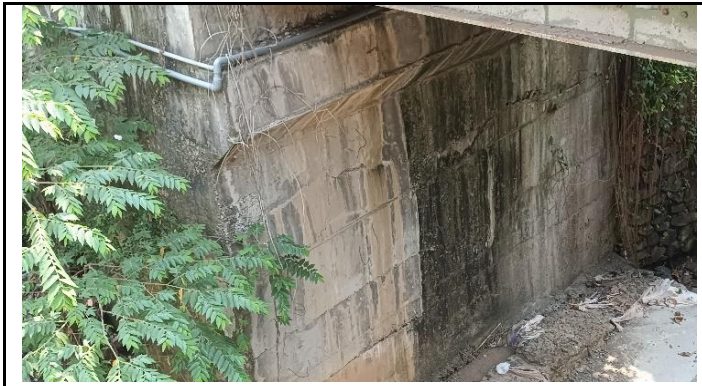
KONDISI KEPALA JEMBATAN BERLUMUT
