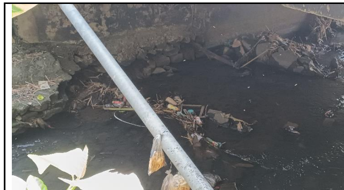
KONDISI KEPALA JEMBATAN TERGERUS
