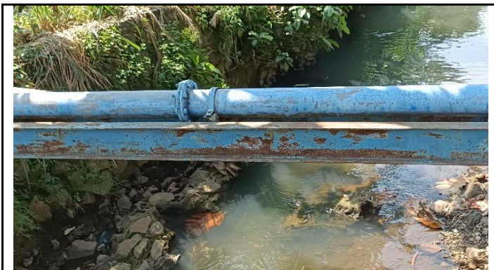
KONDISI PIPA UTILITAS BERKARAT
