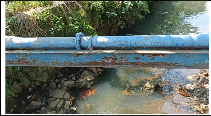
KONDISI PIPA UTILITAS BERKARAT
