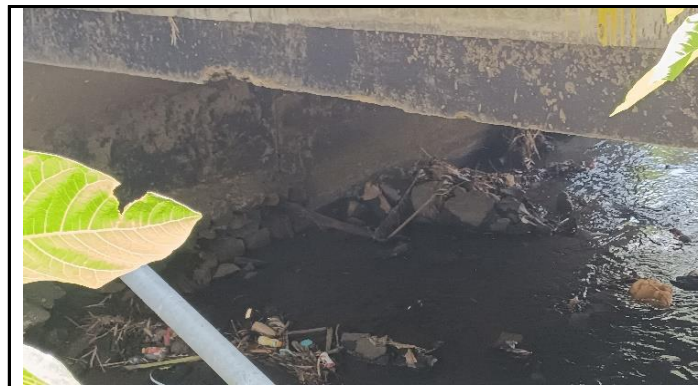
GELAGAR BETON BERTULANG RETAK
