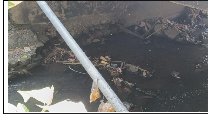
KONDISI KEPALA JEMBATAN TERGERUS
