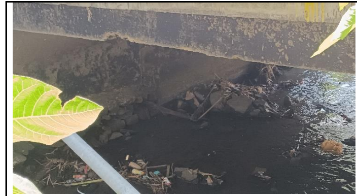
GELAGAR BETON BERTULANG RETAK
