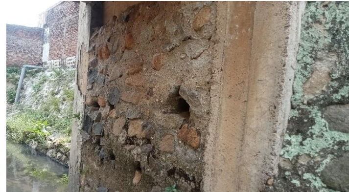
KONDISI KEPALA JEMBATAN BERLUBANG
