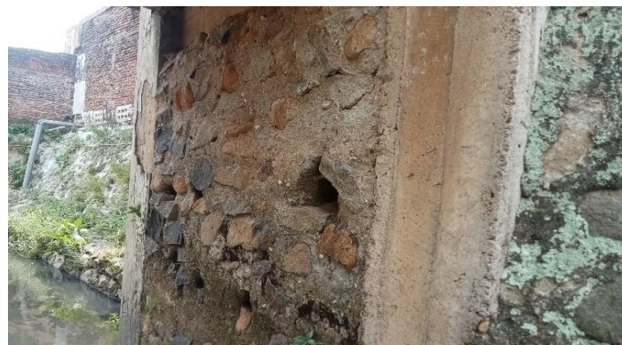
KONDISI KEPALA JEMBATAN BERLUBANG
