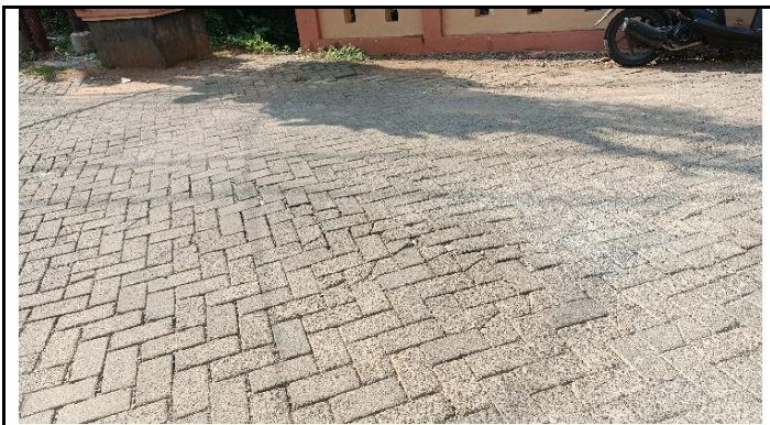
KONDISI LAPISAN PERMUKAAN LANTAI BERGELOMBANG
