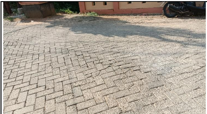
KONDISI LAPISAN PERMUKAAN LANTAI BERGELOMBANG
