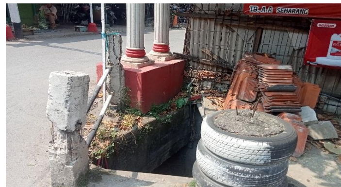
TIANG SANDARAN PECAH
