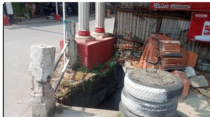
TIANG SANDARAN PECAH
