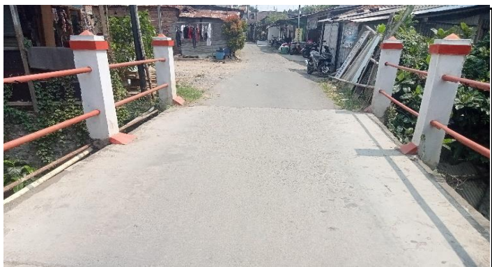
KONDISI LAPISAN PERMUKAAN LANTAI
