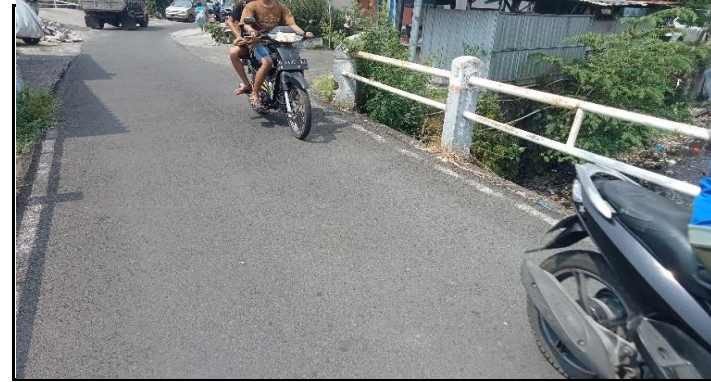
KONDISI LAPISAN PERMUKAAN LANTAI
