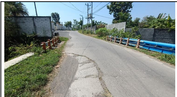
JALAN PENDEKAT RETAK
