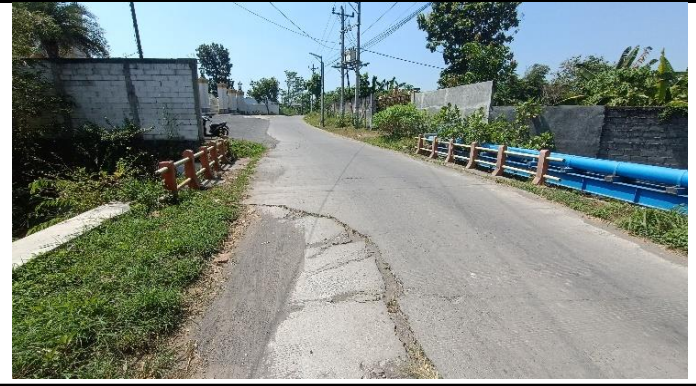
JALAN PENDEKAT RETAK
