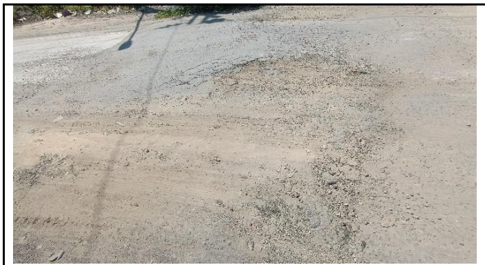
LAPISAN PERMUKAAN LANTAI BERGELOMBANG
