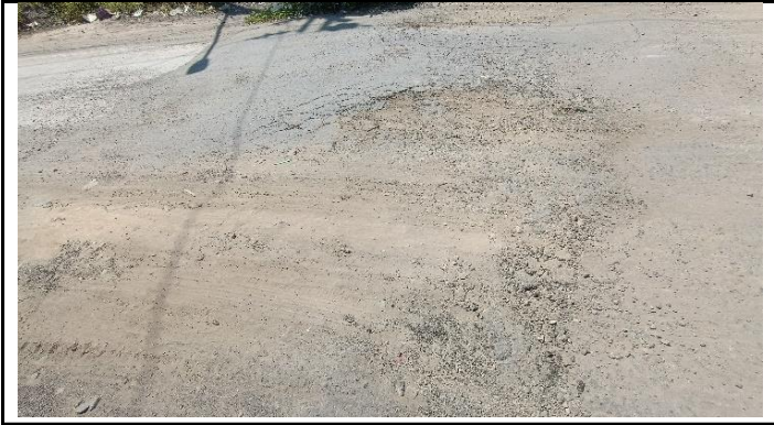
LAPISAN PERMUKAAN LANTAI BERGELOMBANG
