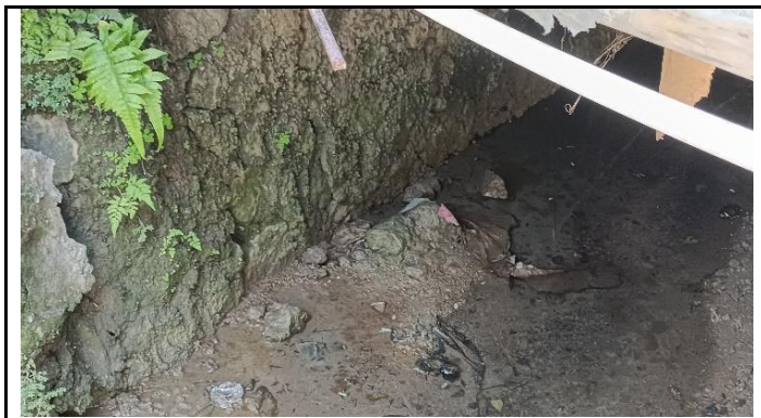
KONDISI BANGUNAN BAWAH BERLUMUT
