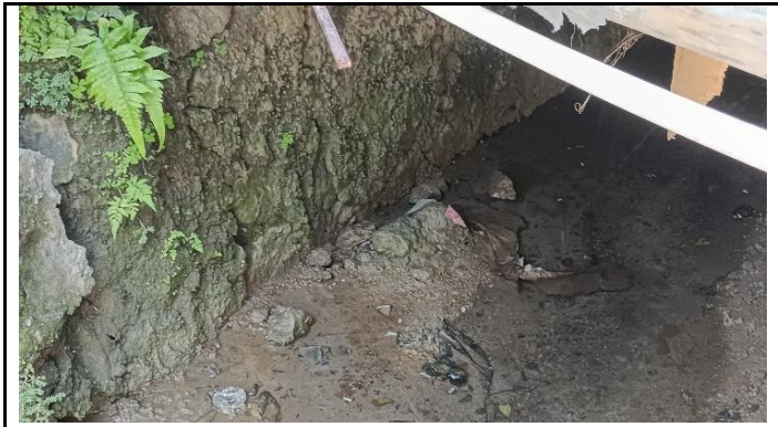
KONDISI BANGUNAN BAWAH BERLUMUT
