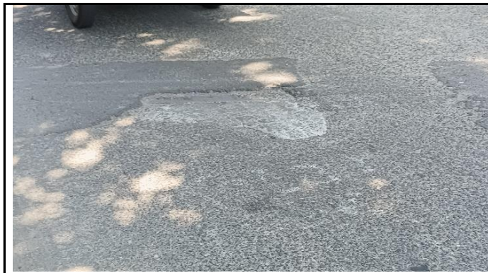
LAPISAN PERMUKAAN LANTAI BERLUBANG
