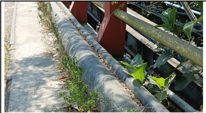
KONDISI TROTOAR DAN SANDARAN
