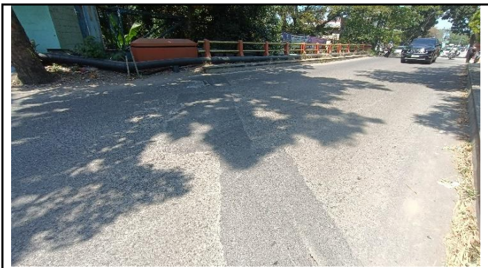
KONDISI SAMBUNGAN LANTAI
