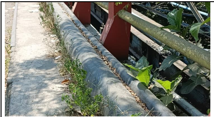
KONDISI TROTOAR DAN SANDARAN
