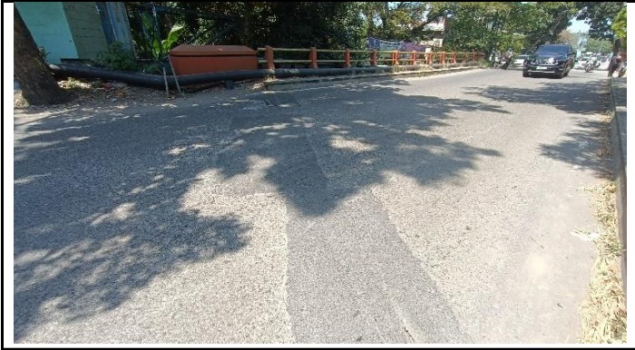
KONDISI SAMBUNGAN LANTAI
