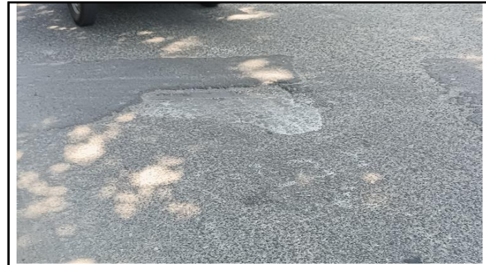
LAPISAN PERMUKAAN LANTAI BERLUBANG
