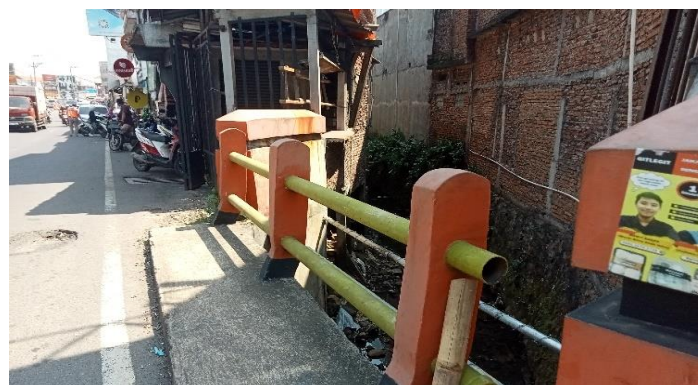
KONDISI SANDRAN DAN TROTOAR
