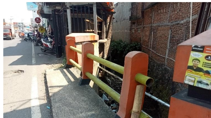
KONDISI SANDRAN DAN TROTOAR
